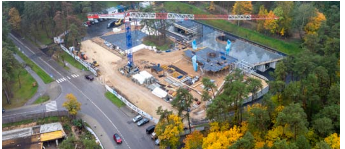
Naujojo komplekso statybas planuojama pabaigti kitų metų antroje pusėje / Edgardo Tamkevičiaus nuotrauka
